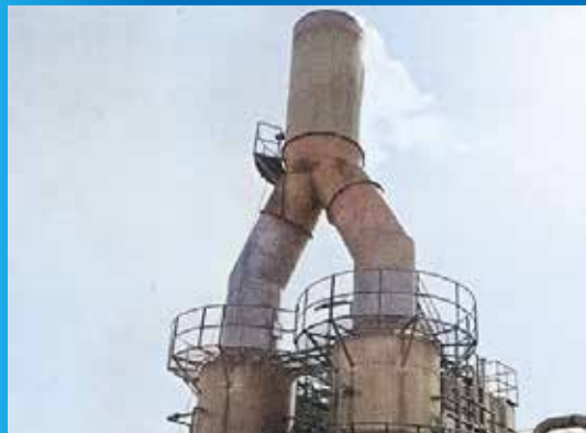
排煙脱硫装置
